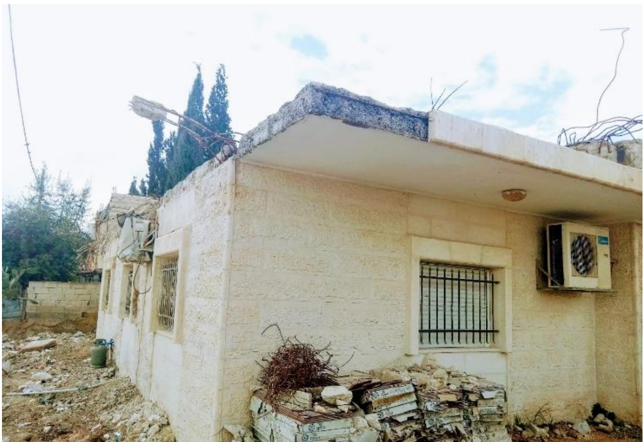
Ein teilweise abgerissenes Haus in Issawiyeh, JLAC® (2020)
